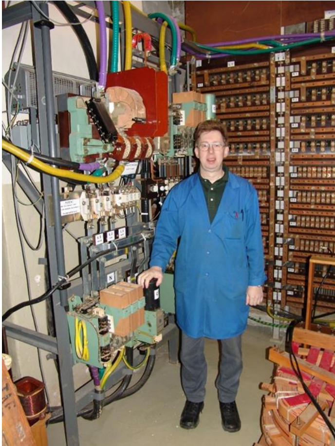
Der Schaltraum für die Hochspannungsanlage, ca. 2002 rechts sieht man noch Spulen für die Prüfungen
